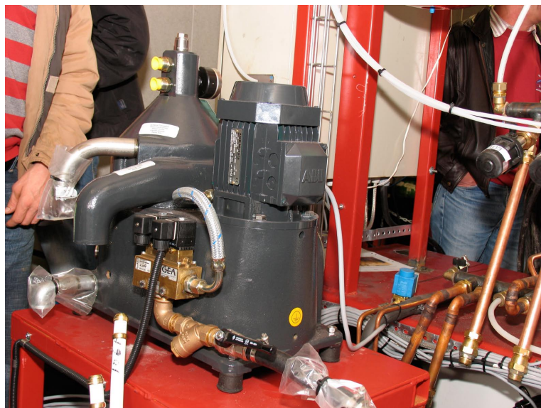
Här står den nya separatorn som skall kopplas in i RME-processen i ett virrvarv av rör.
